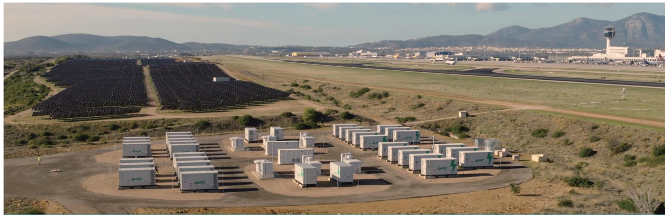
雅典国际机场-全球最大机场光储一体化航空枢纽 地点：希腊雅典 配置：123.8MWh晶科蓝鲸液冷储能系统，共36套集装箱式储能系统 模式：自发自用，全年现场清洁能源储存与利用
