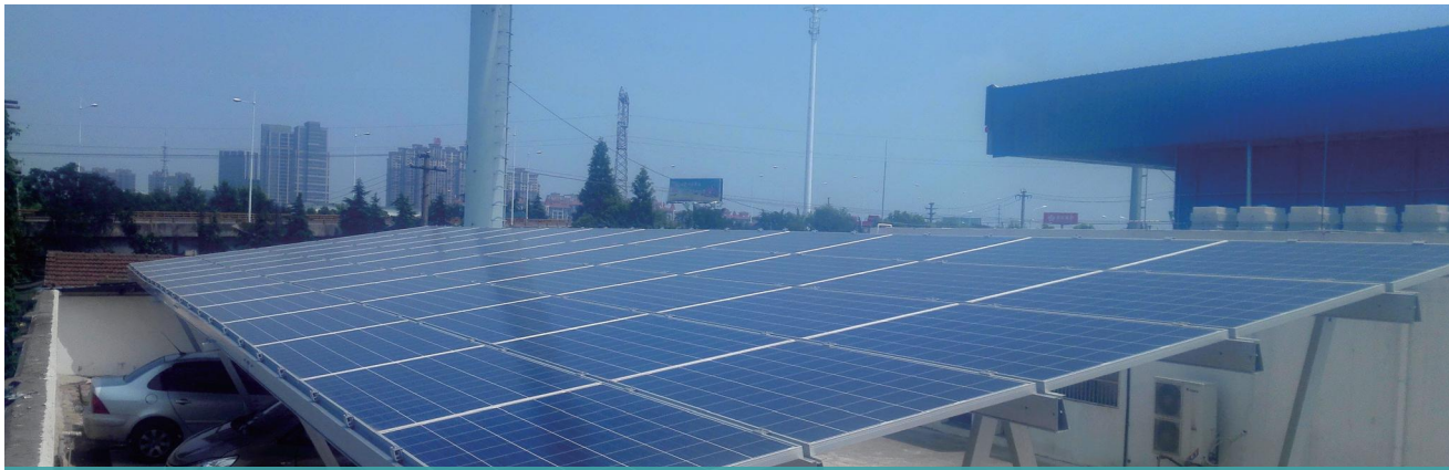
中化道达尔光伏加油站项目 地点：江苏无锡 光伏容量：共计铺设120块光伏组件，装机量为30kw，预计年发电量可达35370kWh 模式：自发自用
